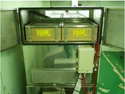
フィルター部から天井風洞部
